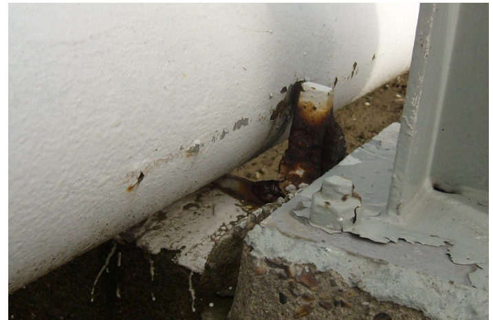
Vista detallada de la corrosión bajo soporte detectada al interpretar los resultados de la prueba de ondas.
