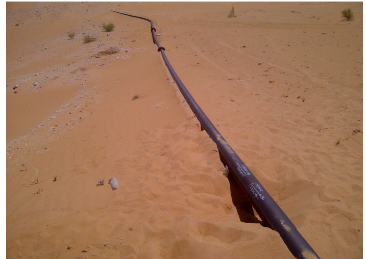
Vista general de la línea de flujo de 6".
