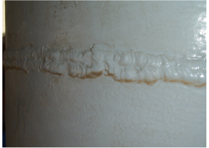
Vista detallada de soldadura con falta de penetración en la raíz, lo cual no es detectable visualmente
